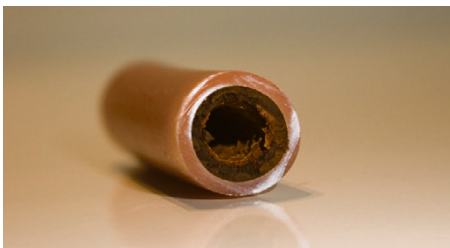
Conduite de chauffage au sol fragilisée et encrassée.
